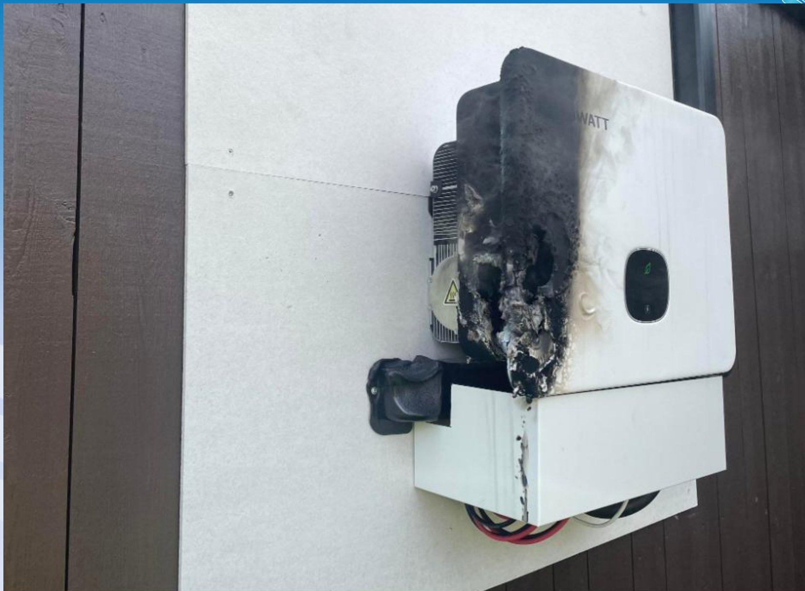
FEIL: Styringsskapet tok fyr av seg selv. Trolig er det snakk om en teknisk feil, i følge brannvesenets utrykningsleder. Foto: Jenny
